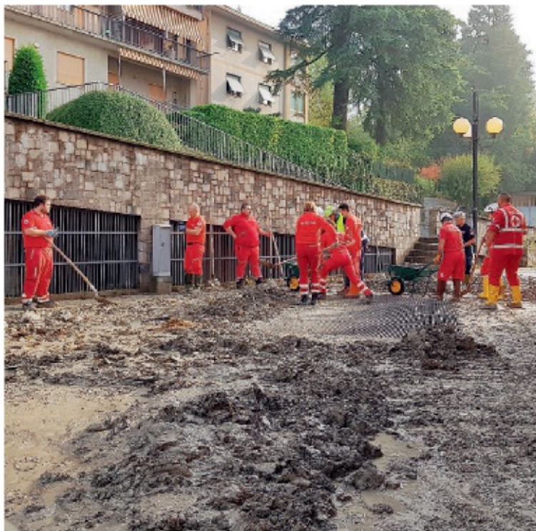
PIAZZA DANTE La Protezione Civile al lavoro per liberare la strada dalla frana
