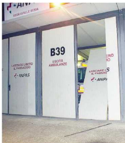
L'autorimessa della Pabv con la porta sfondata (foto Carlotta Tonco)
